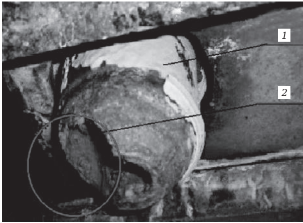
Рис. 2. Эрозия стакана-коллектора (1); 2 — зона эрозии
